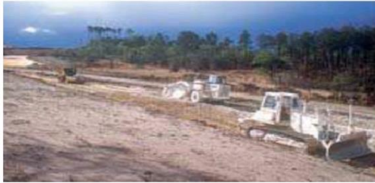
Figure I.26: vue générale d'UN chantier de traitement de sol (documentation technique routes N89 septembre 2004)
