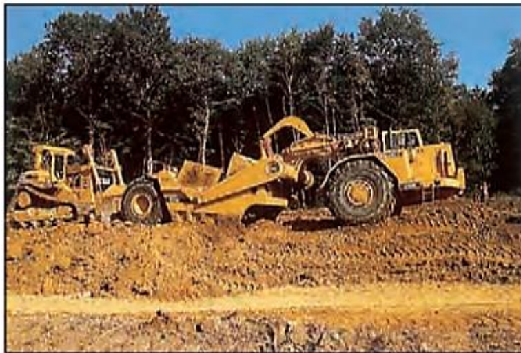
Figure I.4 : Extraction des sols de classes A2m et A3m par conditions météorologiques "évaporantes" : des conditions de chantier idéales.
