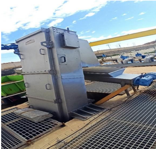
a) Vue d'arrière du dégrilleur.
