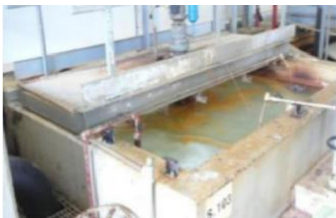
Figure (8) : Cuve floculation « S-103 »
