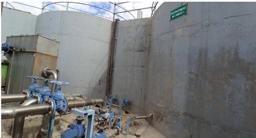
Figure II-6 poste de dessablage déshuilage de STEP de sidi Aissa
