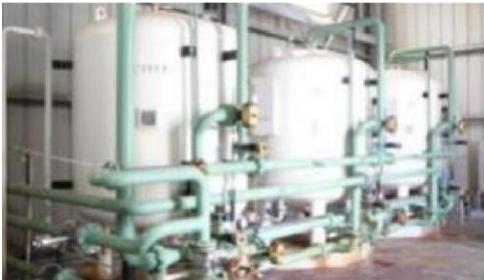
Figure IV-6 : les filtres à sable.
