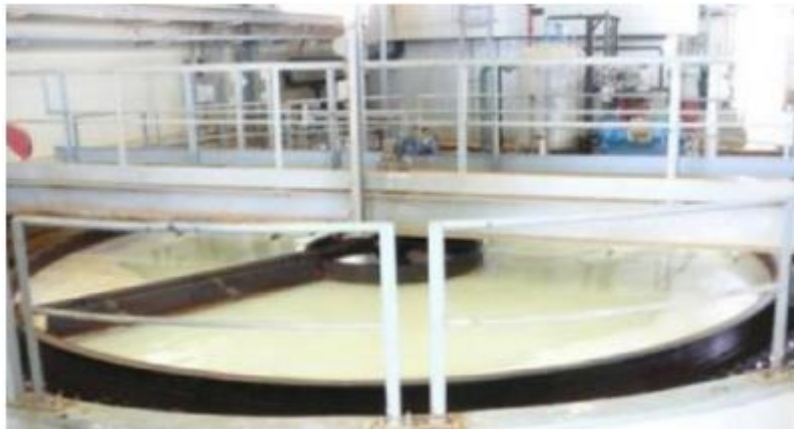
Figure IV-4: la cuve de flottation « S-104 »
