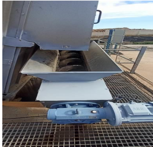
b) Vue du dégrilleur avec la vis
