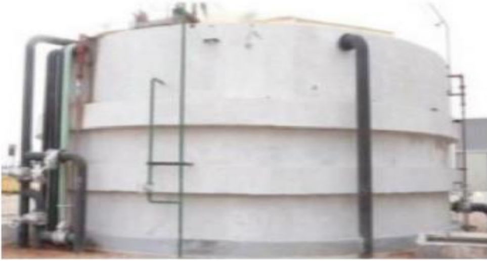
Figure IV-1: Bac tampon ou le de pré -dégrillage S-101
