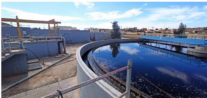
Figure II-8 Décanteur secondaire de la STEP de Sidi aissa.
