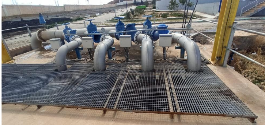
Figure II-5 Pompes de relevage de STEP de Sidi Aissa
