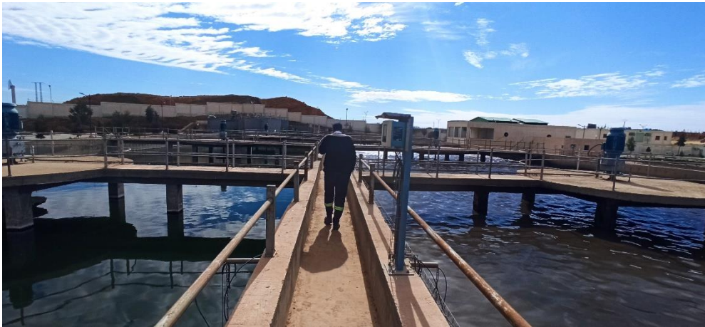
Figure II-7 Bassin biologique de la STEP de Sidi Aissa
