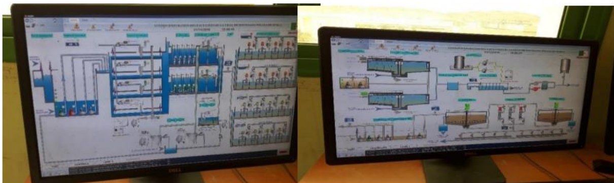
Figure II-13 Logiciel de commande à distance de la STEP de Sidi Aissa.
