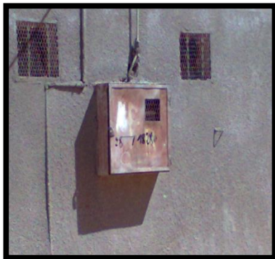
صورة رقم(67):عداد كهربائي
