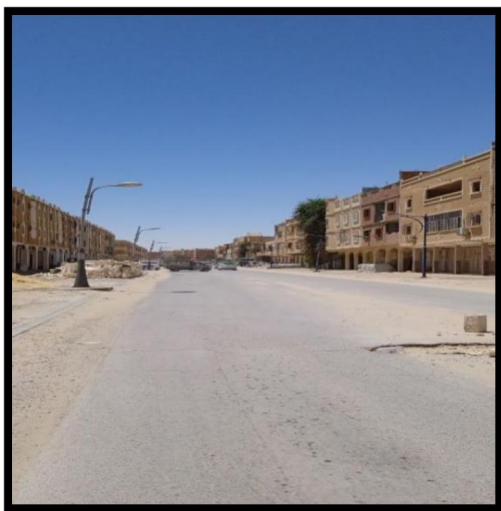
صورة رقم 27: حفر وسط الطريق
