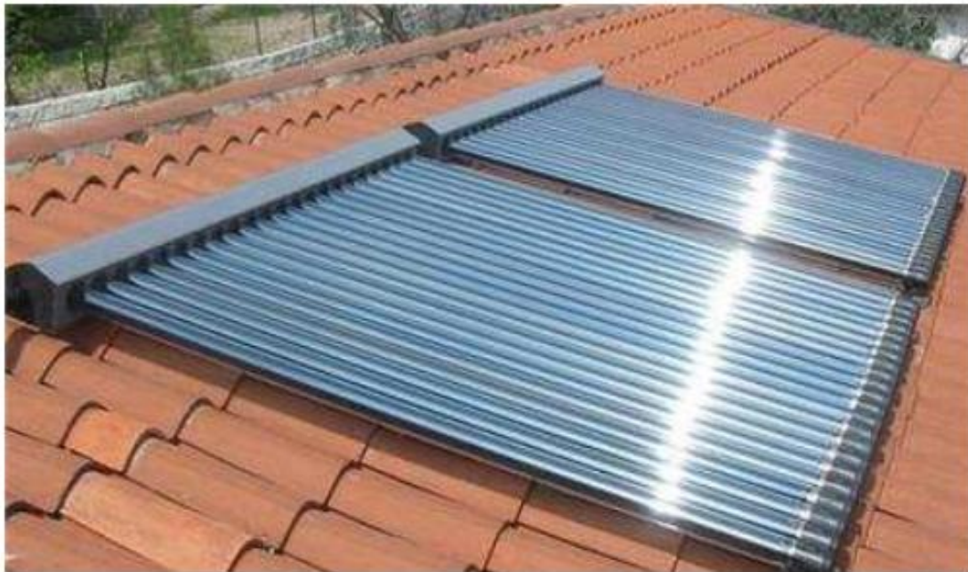
Figure III. 9 : Capteur solaire intégré au toit
