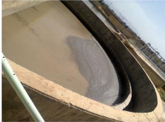
Figure II.10: Epaississeur de boues.
