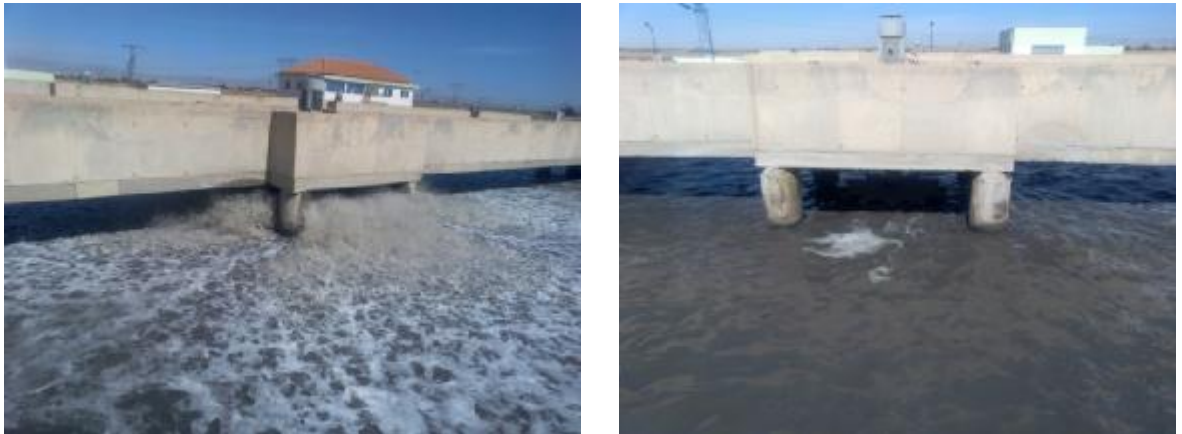
Figure II.7 : Le bassin d'aérations
