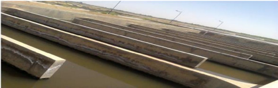
Figure II.9 : bassin de chloration
