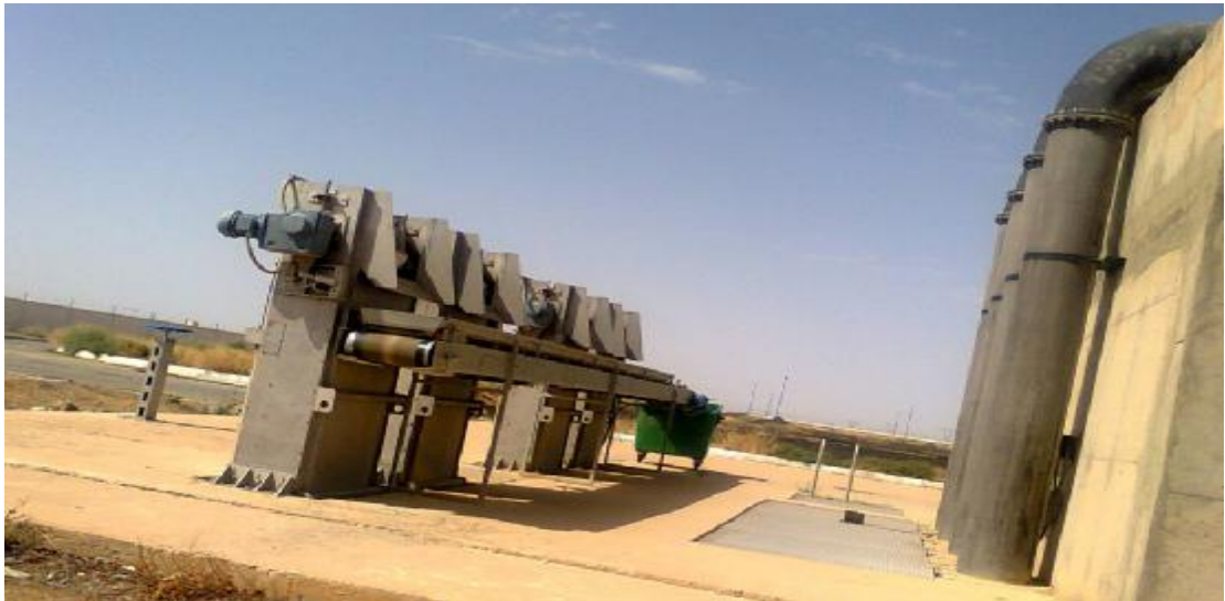
Figure II.3 : Les dégrilleurs grossiers.
