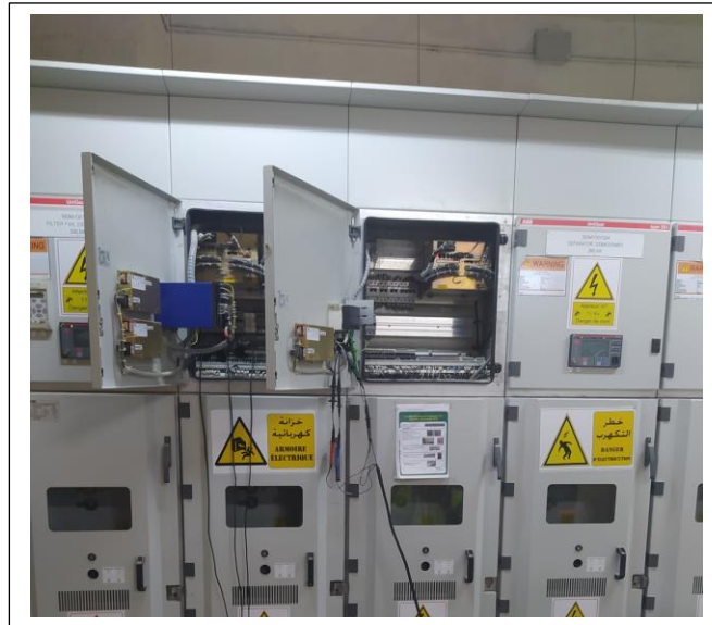
Figure.III.3 : Cellule départ moteur avec emplacement des capteurs des courants « 3 » et des tensions « 3 »
