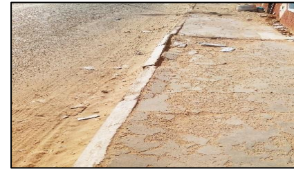
الصورة (27): توضح حالة متدهورة للرصيف
