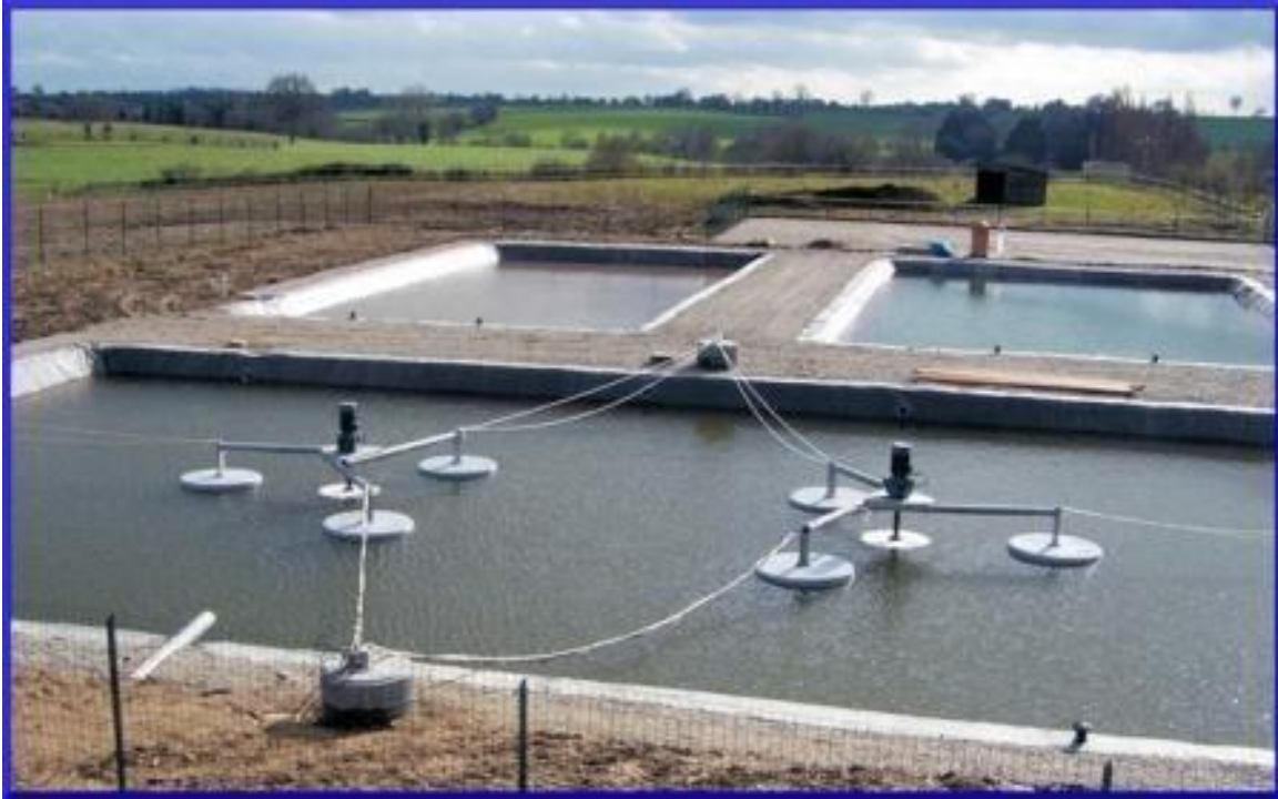
Figure.7 : Photo de bassins de lagunage aéré [79].
