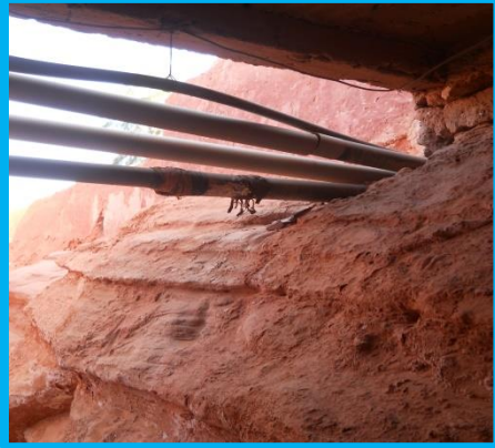
الصورة(63):انابيب المياه و الصرف مختلطة
