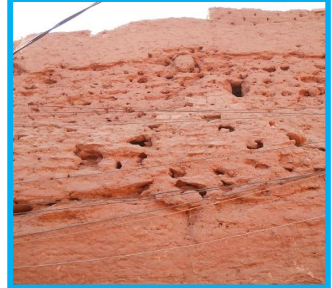
الصورة(61): شبكة الكهرباء تشوه الواجهات
