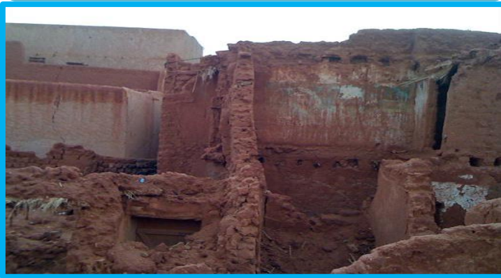
الصورة (65): نتائج للاستعمال الغير جيد لمواد البناء
