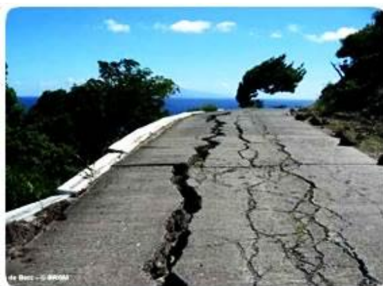
Fissures sur la route départementale 213 (Terre de Bas)
