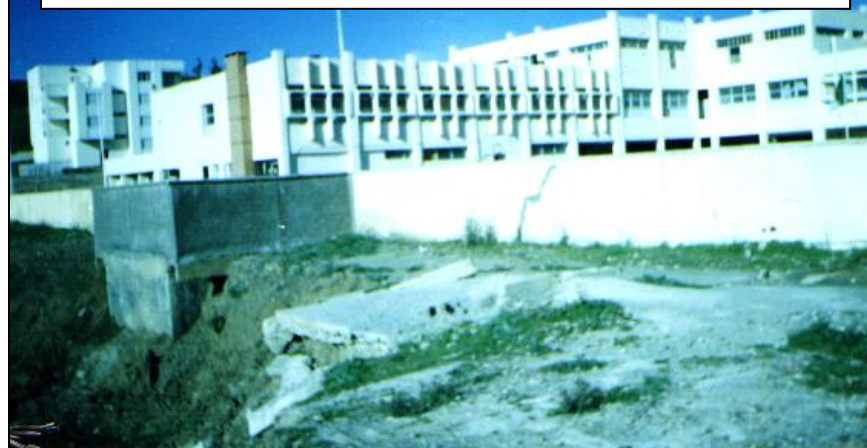
Photo 2 - Fissuration du mur de clôture du Technicum et déchaussement de la soute à mazout
