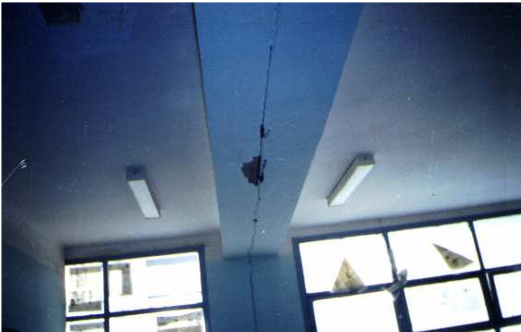
Figure 4.7. Vue de l'intérieur du joint de dilatation ouvert.
