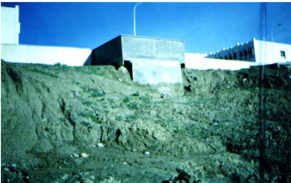
Figure 4.3. Déchaussement de la soute à mazout (ouvrage annexe du Lycée).
