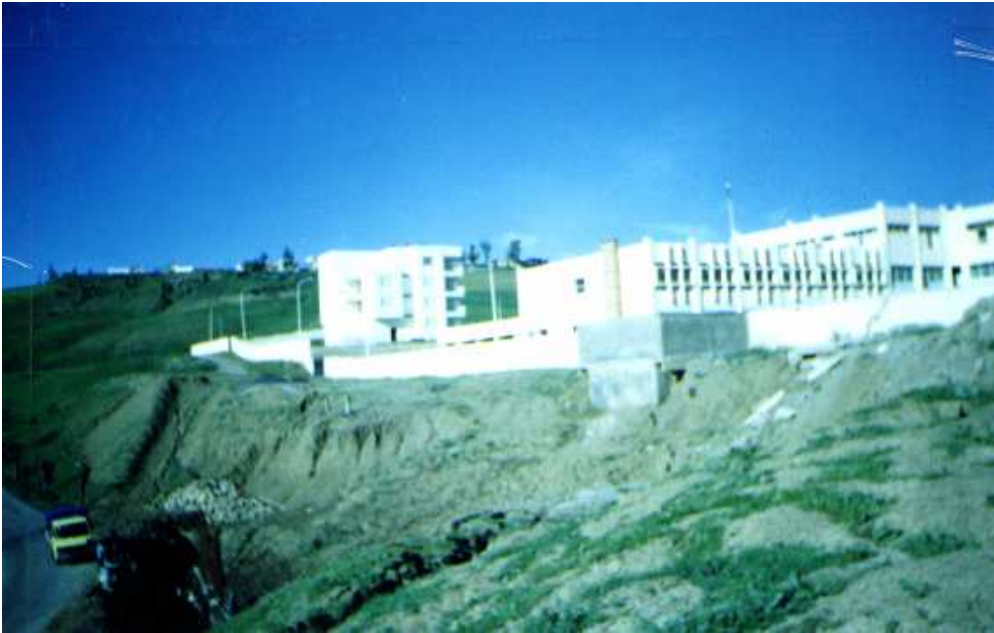
Figure 4.2. Vue générale du glissement de terrain à proximité du Lycée.
