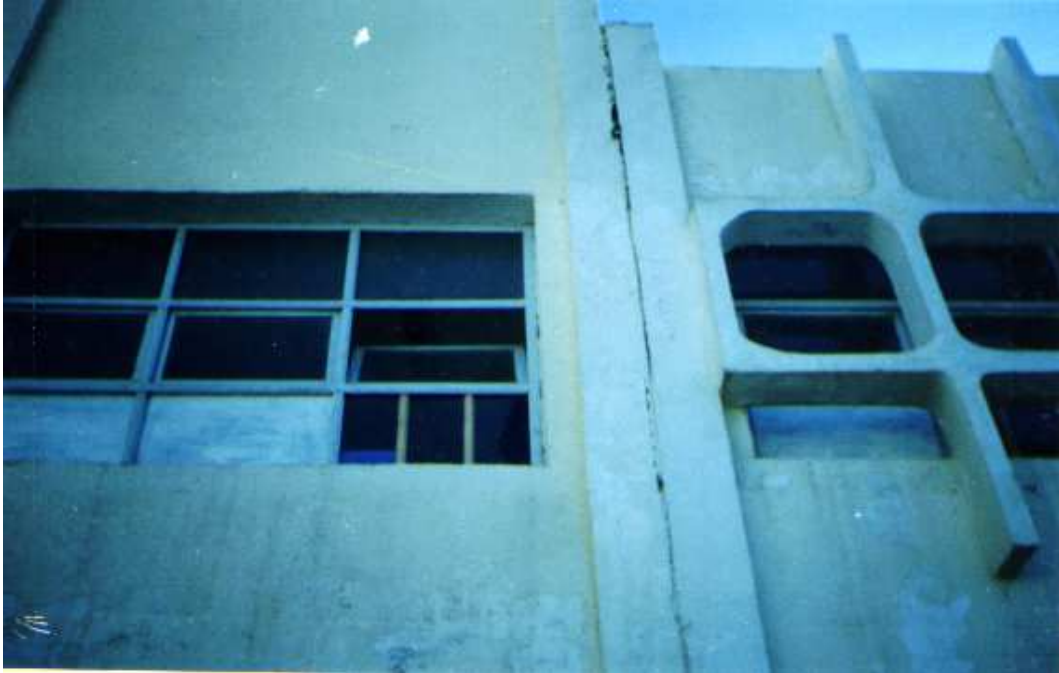
Figure 4.6. Ouverture du joint de dilatation de deux blocs mitoyens du Lycée.
