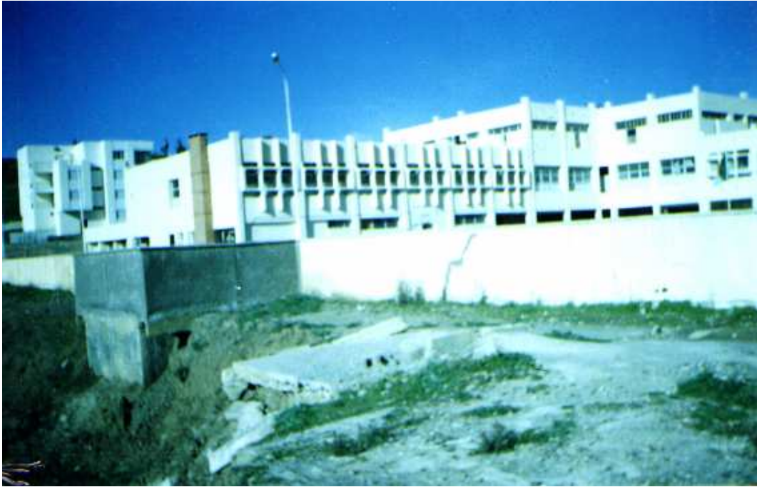
Figure 4.4. Fissuration du mur de clôture du Lycée.
