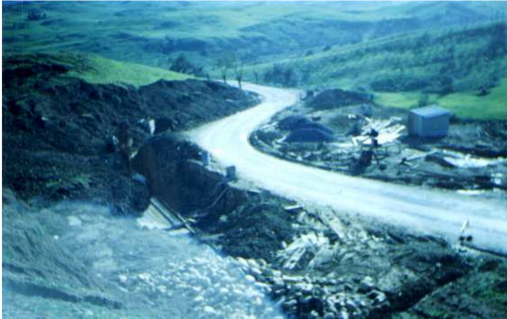
Figure 4.8. Vue de la chaussée RN25 en contre-bas du talus.
