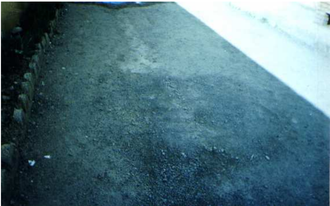
Figure 4.5. Affaissement de la cour du Lycée à proximité du mur de clôture.
