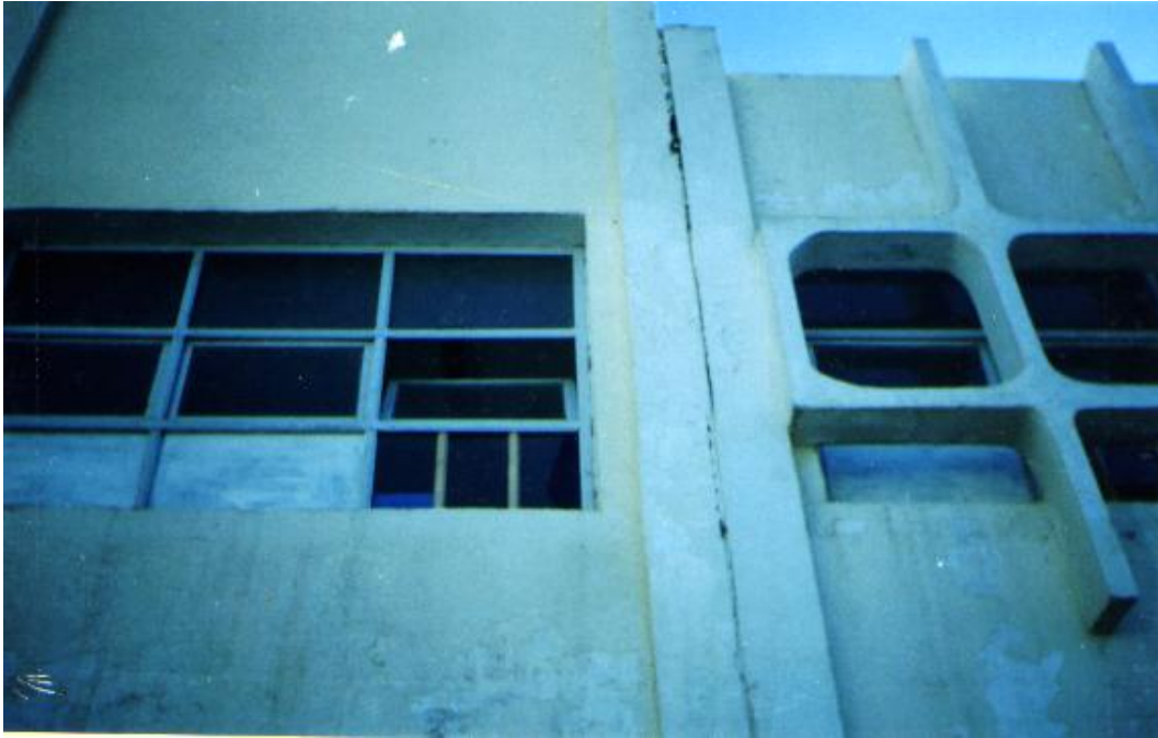
Figure 4.9. : Ouverture du joint de dilatation de deux blocs mitoyens du technicum.
