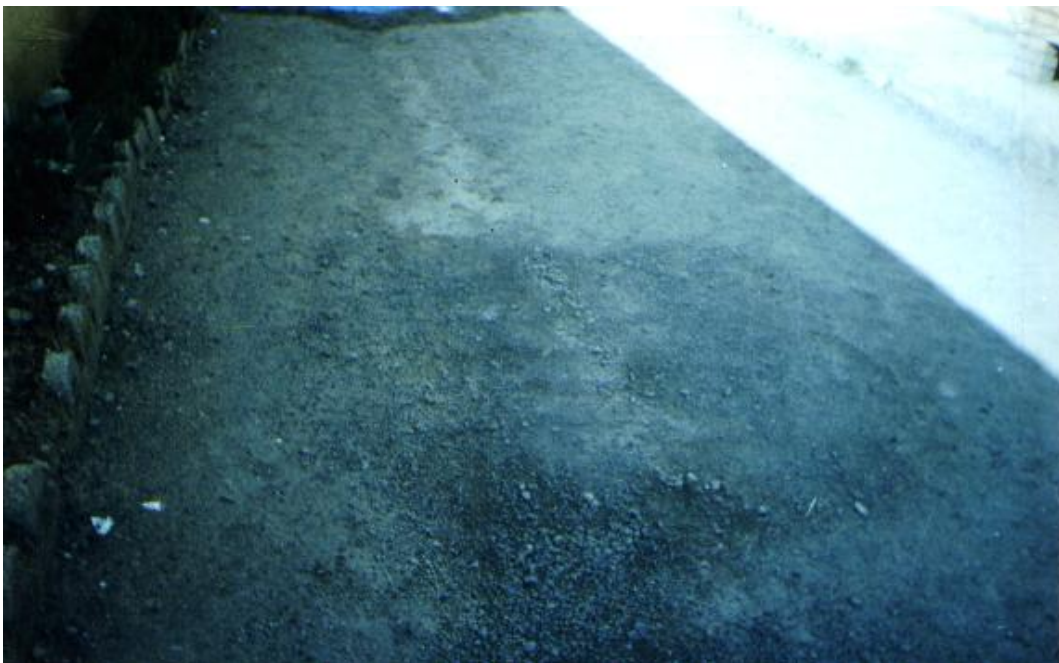
Figure 4.8. : Affaissement de la cour du technicum à proximité du mur de clôture.
