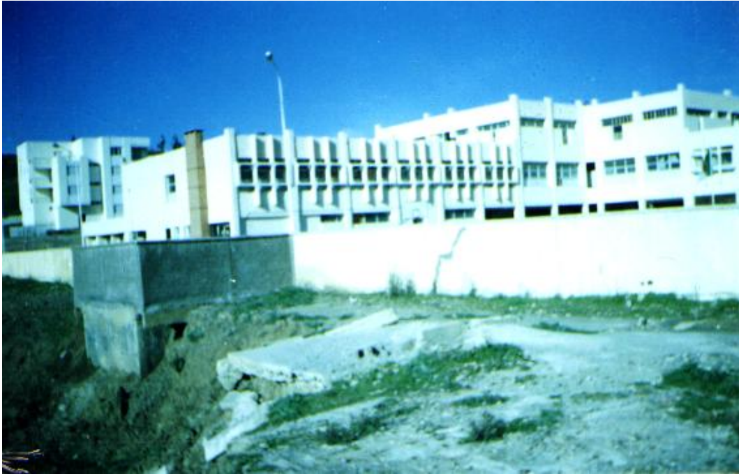
Figure 4.7. : Fissuration du mur de clôture et déchaussement de la fondation de la soute à mazout.
