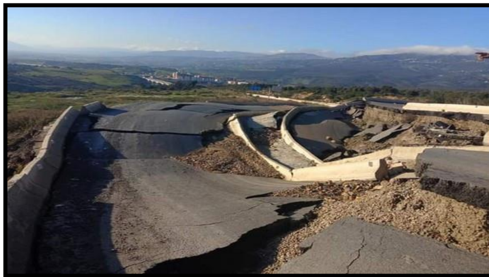
Figure I.14 : Affaissement de terrain à Azazga (Alger).
