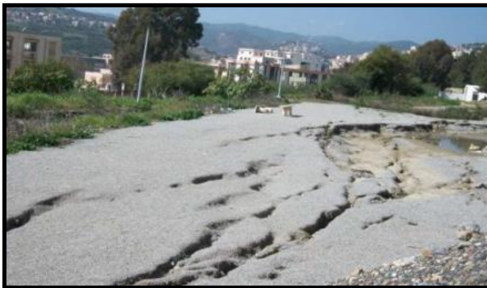
Figure I.11 : Fissures, tassements sur la plateforme du stade à Bejaia.
