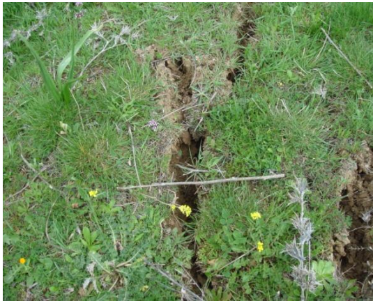
Figure II. 4 : Fissures au niveau du talus
