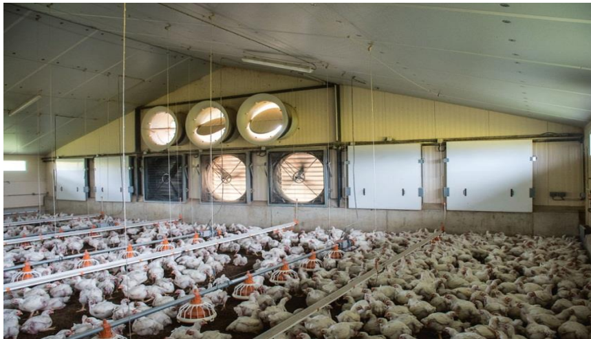
Figure 6 : ventilation bâtiment d'élevage de poulet.
