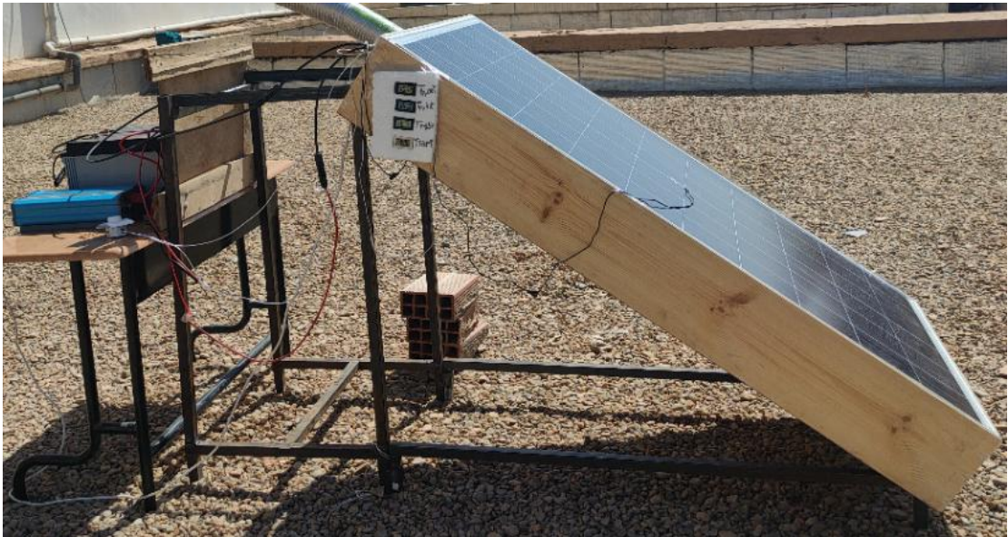
Fig. 4.1 Banc d'essai du capteur solaire PV/TH hybride à air en charge [3-5]
