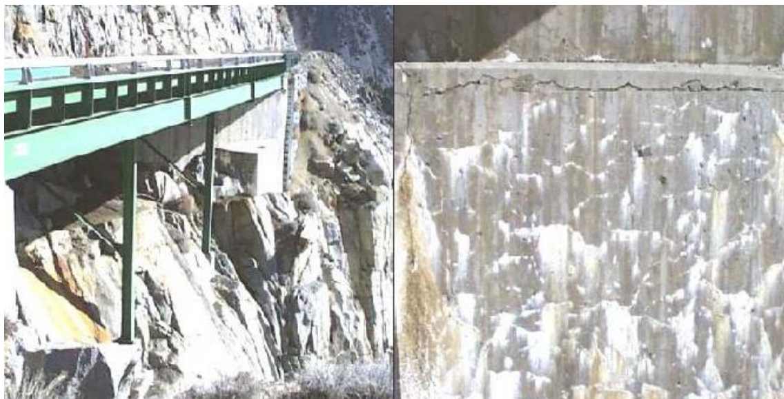
Figure 1.4 : Des cas pathologiques d'éléments en béton en contact de sulfate. [26]
