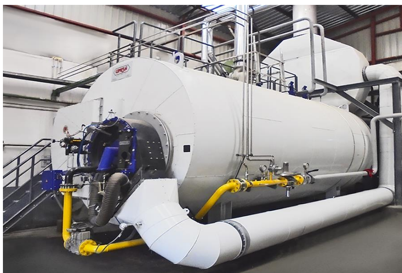
Figure 17: chaudière à gaz
